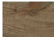
Raue Stellen auf der Holzoberfläche
